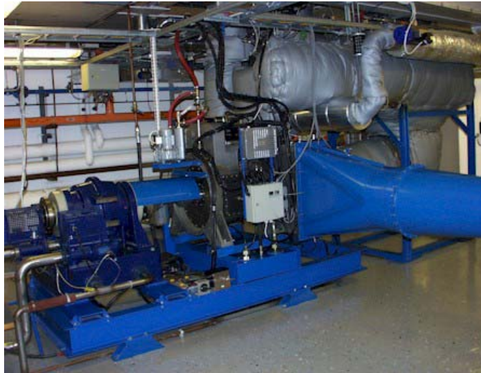
Abbildung 4-9: Die erste Humid Air Turbine der Welt; 600 kW, 3,5 kg/s Luftstrom, Druckverhältnis 8 [35]
